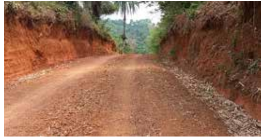
Route de dessert en construction pour aider à connecter les agriculteurs aux marchés des intrants et des produits agricoles
